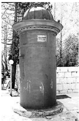
Prvi cetinjski transformator (foto: V. Radonjić 2013.)
